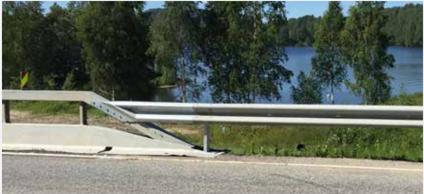
Vegkant; Ensidig overgang VG-W rekkverk
